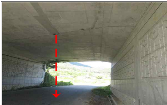
바닥판하면 상·하행선 S1 접합부 실란트 손상 및 누수흔적
