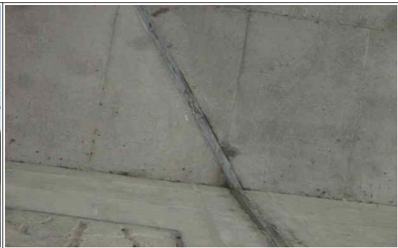
바닥판하면 상·하행선 S1 접합부 실란트 손상
