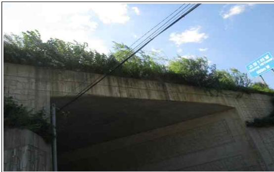
바닥판하면 상행선 S1 우수에 의한 오염
