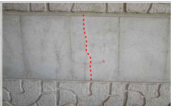
교대 하행선 A1 수직균열(폭 0.2mm)
