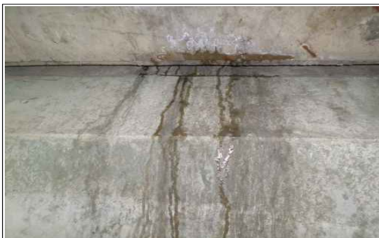
바닥판하면 상행선 S1 누수흔적(신축이음 하부 누수)
