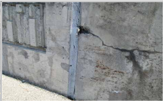
방호벽 상행선 A2측 접속도로 콘크리트 박락
