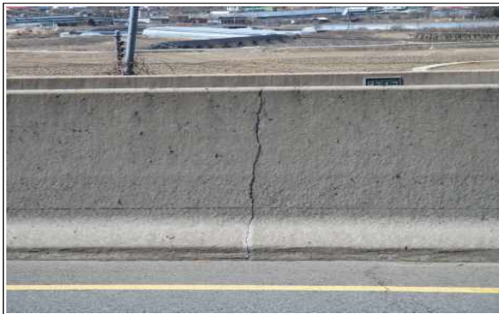
중분대 상행선 S1 균열(폭 1.0mm)
