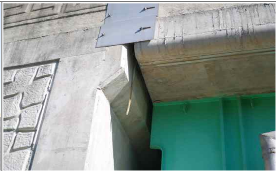
배수시설 하행선 A2측 유도배수관 길이부족
