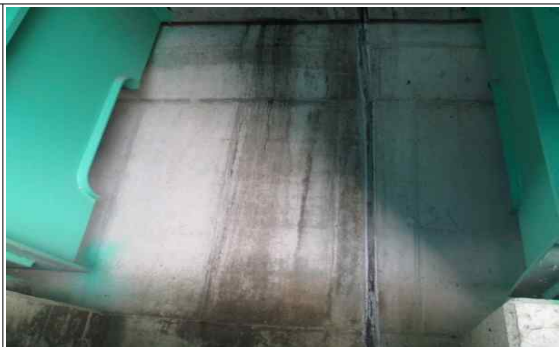
교대 상행선 A1 홍벽 누수흔적
