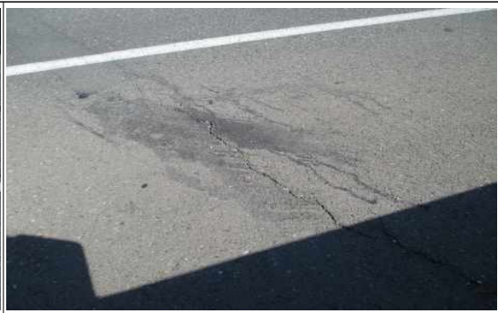
교면포장 하행선 S1 아스콘 균열
