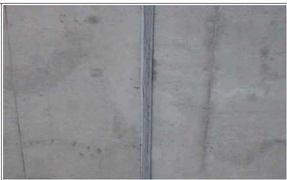
바닥판하면 상·하행선 S1 접합부 실란트 재손상
