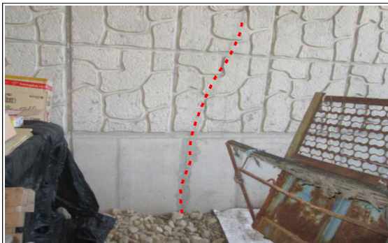
교대 하행선 A1 보수부 재균열(폭 0.6mm)
