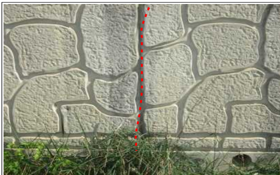
옹벽 하행선 시점측 수직균열(폭 0.3mm)
