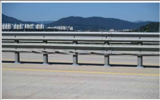
중분대 상행선 S1 차량충돌에 의한 가드레일 손상
