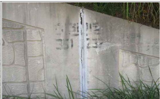
옹벽 상행선 종점측 실란트 손상
