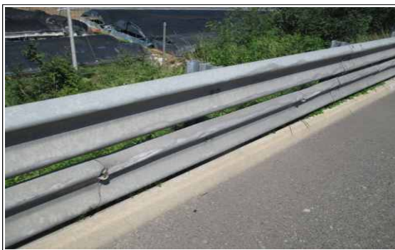
방호벽 하행선 A2측 접속도로 차량충돌에 의한 가드레일 손상
