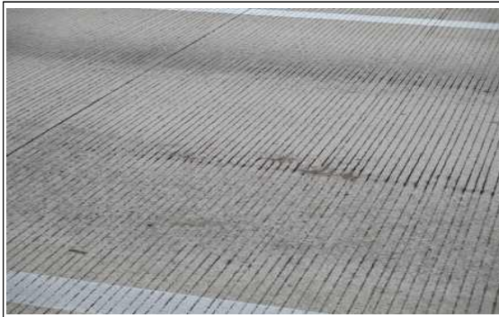
교면포장 상행선 S1 패임
