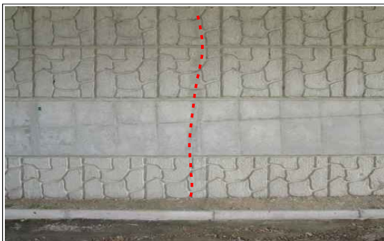
교대 상행선 A1 보수부 재균열(폭 0.2mm)
