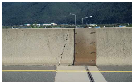
중분대 하행선 A2측 접속도로 균열(폭 1.0~1.5mm)
