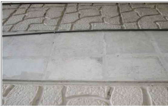
교대 상행선 A1 균열(폭 0.3mm)
