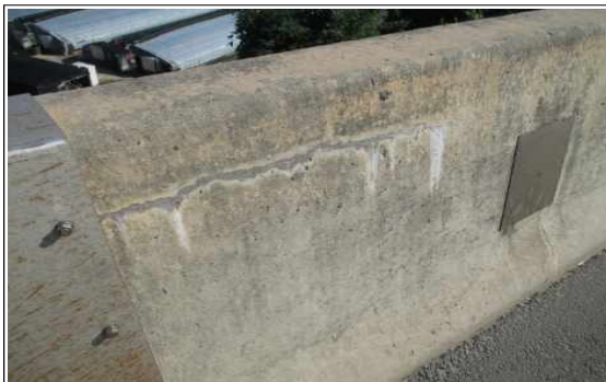
방호벽 상행선 A1측 접속도로 균열부 백태
