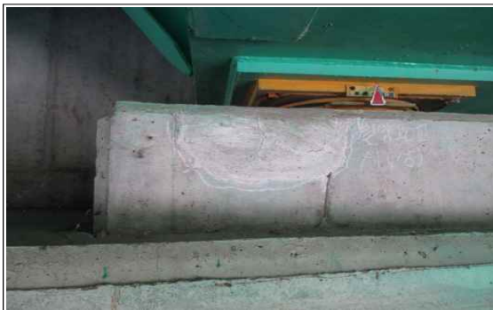
교량받침 상행선 A1 SH2 받침콘크리트 보수 불량
