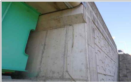
배수시설 상행선 A2측 유도배수관 길이부족(연결불량)
