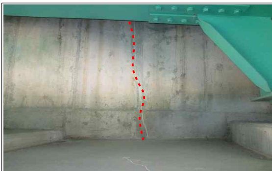
교대 하행선 A2 홍벽 균열(폭 0.3mm)
