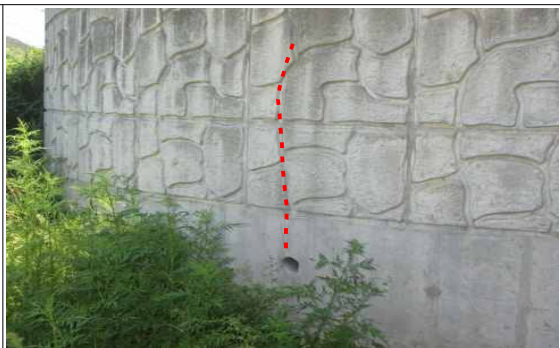
옹벽 하행선 종점측 균열(폭 0.2mm)
